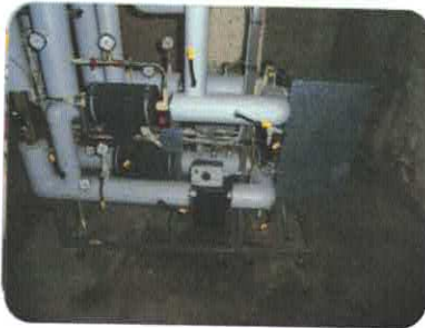
Fjernvarmeunit for opvarmning.
