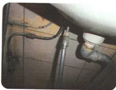
Rørtilslutninger for koldt og varmt vand samt afløb til håndvask i badeværelse.
