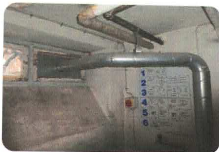
Aftræk fra tørretumbler ført til det fri. Ved udskiftning af tørretumblere anbefales det at nye bliver med kondensstørre.
